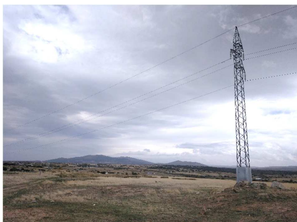
Foto: Línea aérea de alta tensión.
